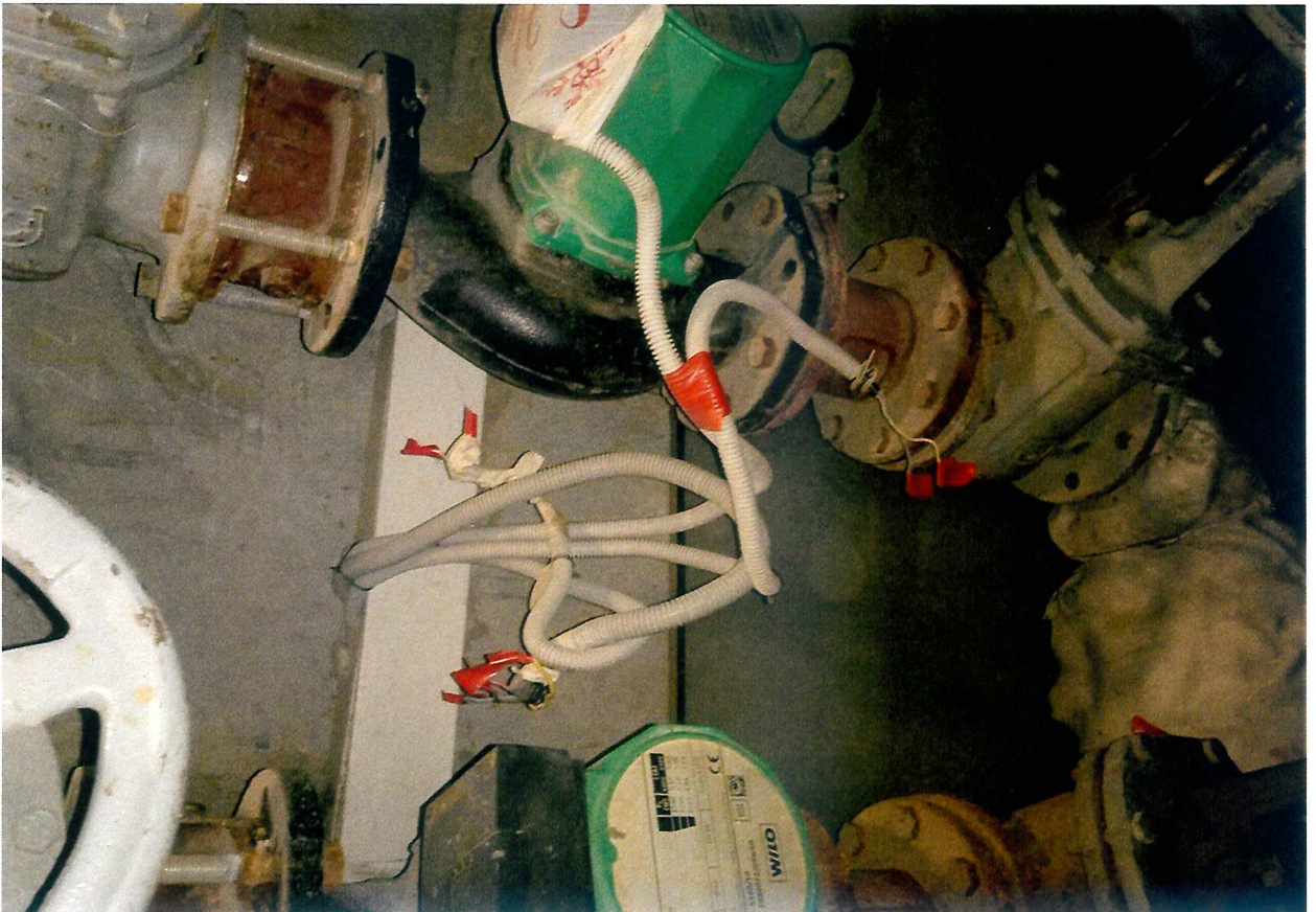
Рис. 3-4 Насосы системы теплоснабжения. (один насос находится в неработающем состоянии, питание отключено).
