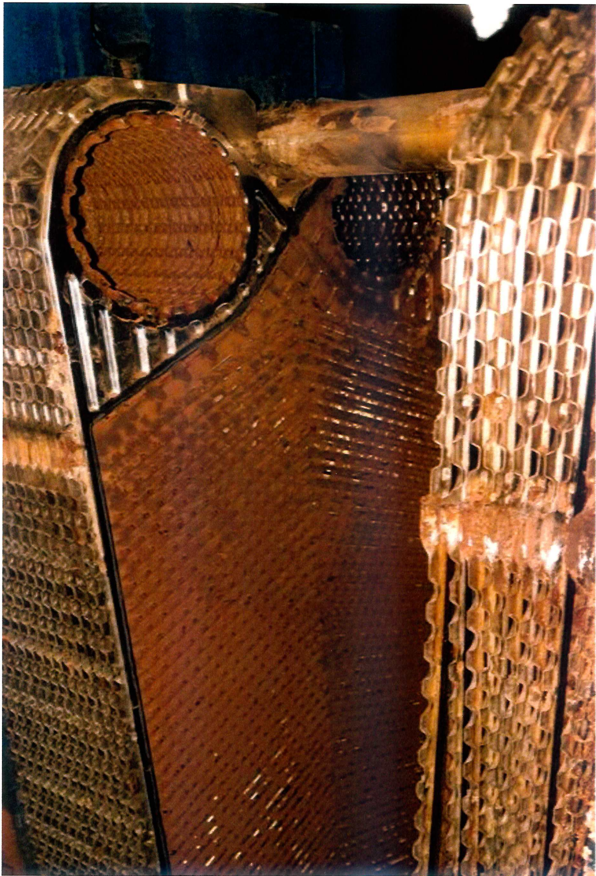
Рис. 10-13 Теплообменный аппарат системы горячего водоснабжения. (пластины имеют сквозные отверстия).
