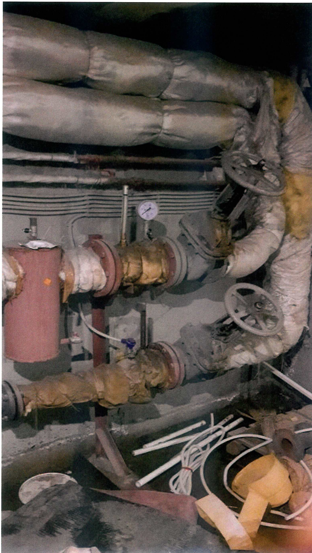
Рис. 14 Вводные задвижки системы теплоснабжения.
