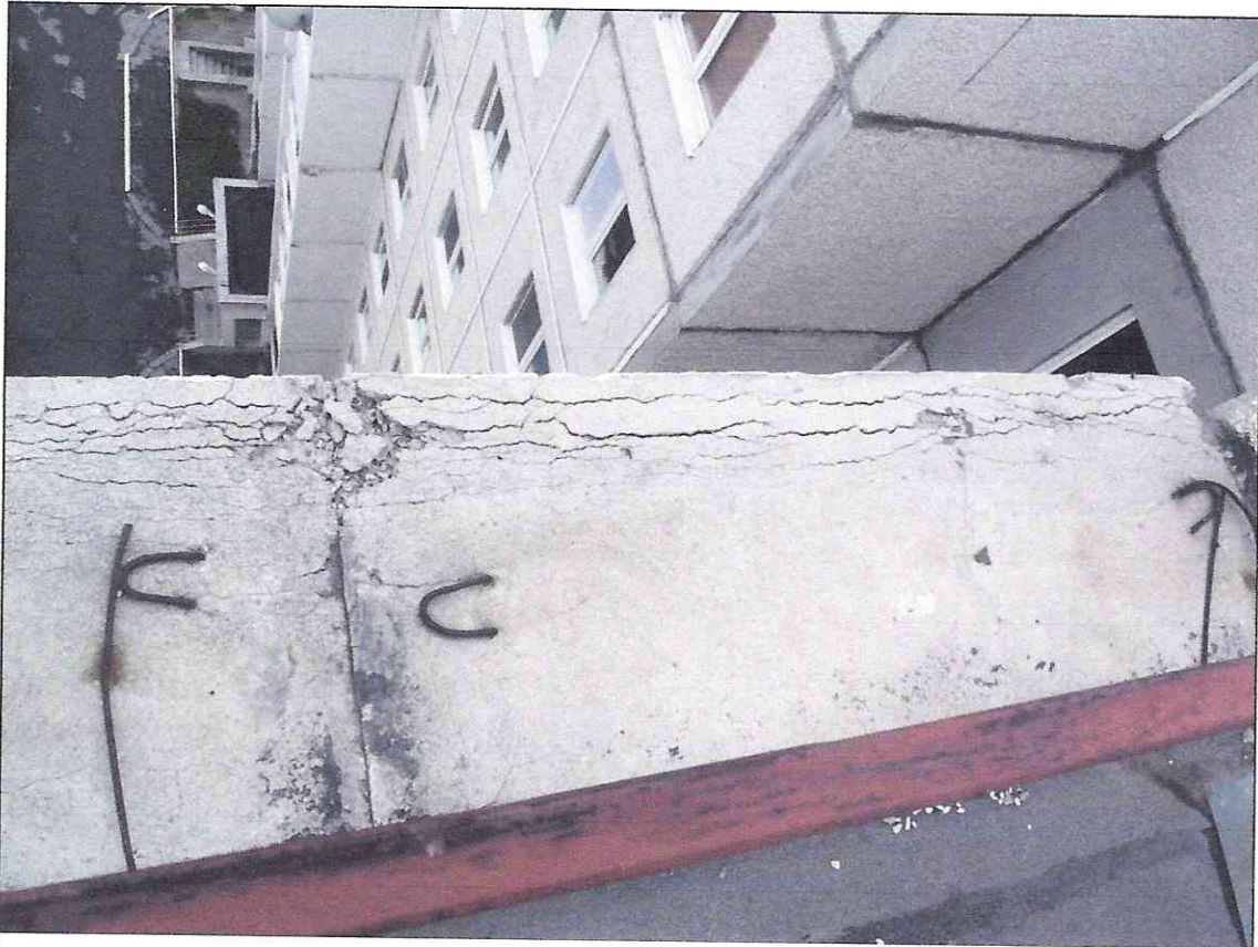
Рис. 11 С.2 Разрушение плит парапета.
