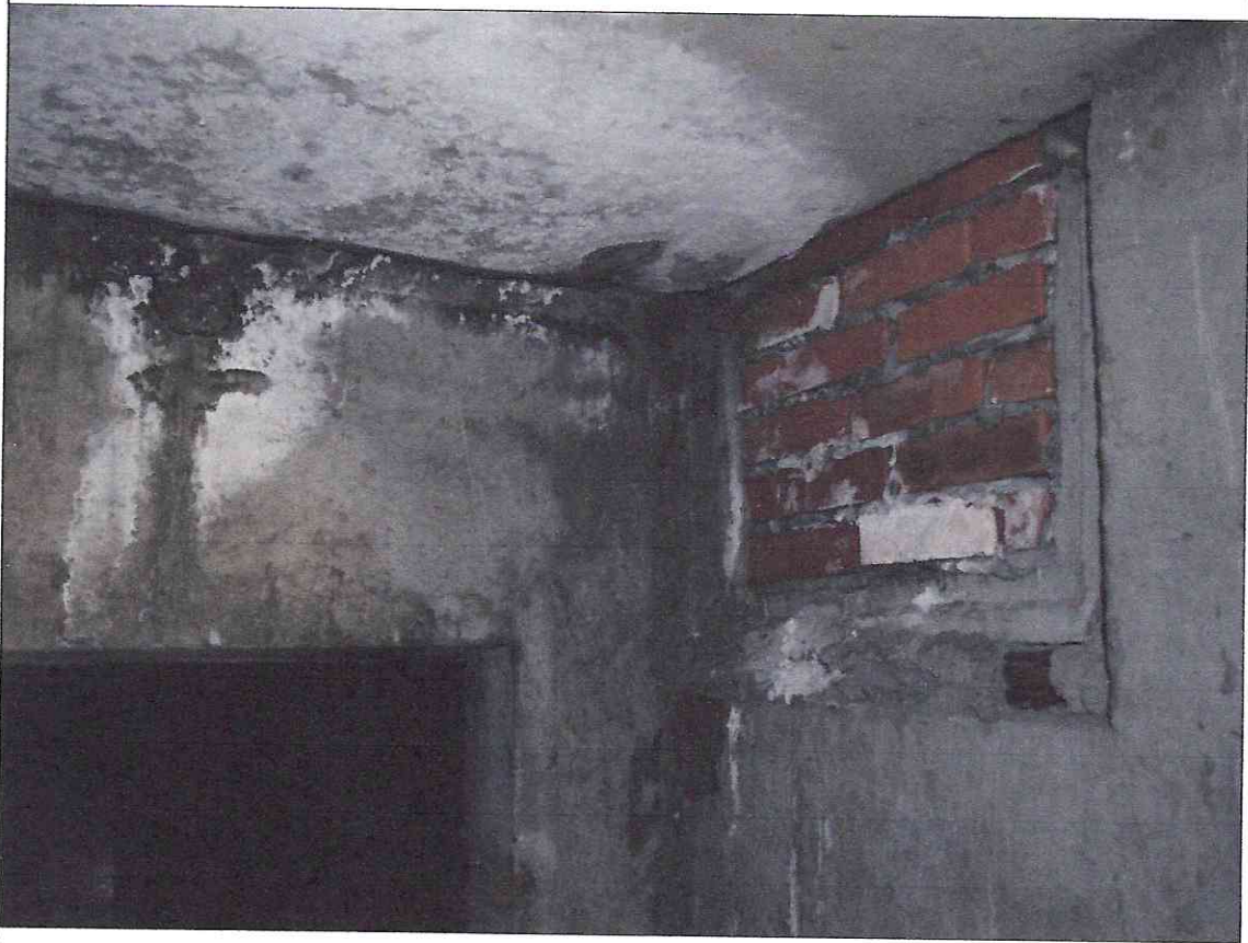
Рис. 22 Секция .С.5 Протечка кровли
