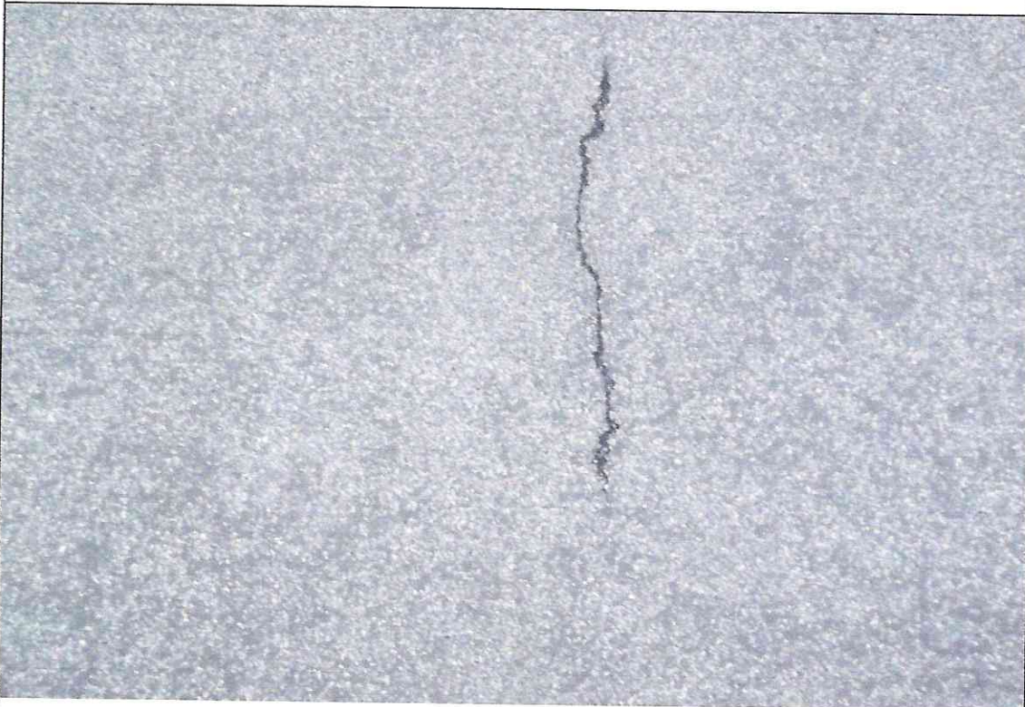
Рис. 12 С.4 Разрушение гидроизоляционного слоя Состояние кровельного покрытия находится в удовлетворительном состоянии, имеются многочисленные трещины, отслоения, структура покрытия хрупкая..
